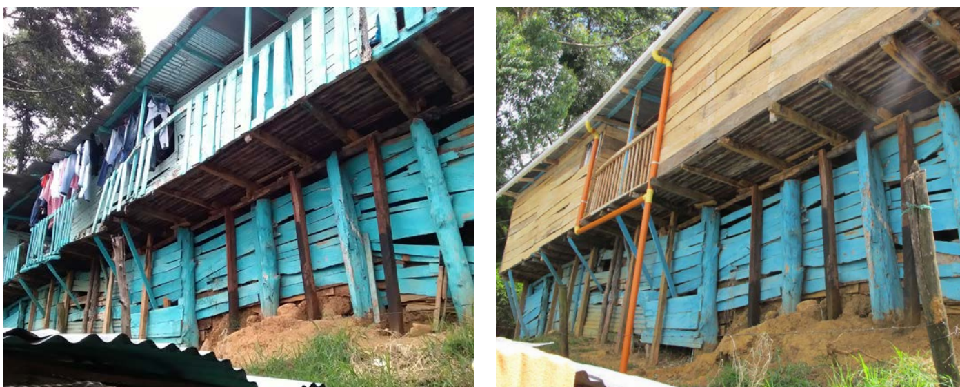
Figuras 14 y 15: Aquí se puede ver la casa “La Mona” (punto de monitoreo número 2) antes y después de las obras de mitigación. Fuente: Equipo de Investigación.
