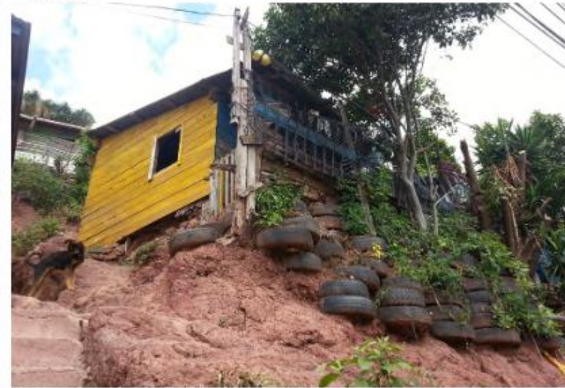
Foto 16: Mala práctica de adaptación en construcción de muro con llantas usadas, Villa Nueva
