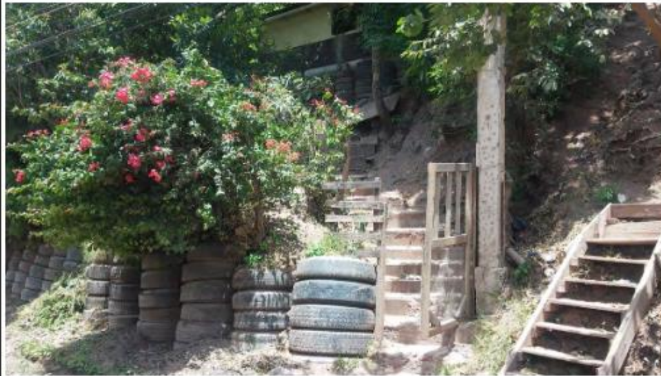
Foto 15: Muro de contención con llantas usadas, Los Pinos
